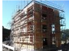
CLTの施工方法の確立及びコストダウンに向けたCLTを活用した先駆的建築の支援
