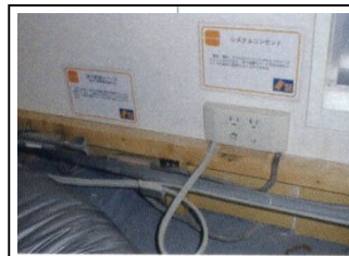
床下配線ピット
